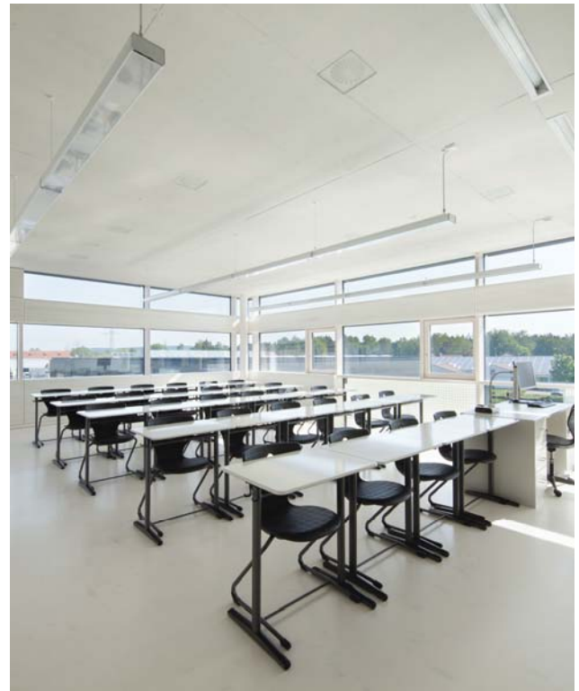
Klassenzimmer mit Ausblaseelementen.
