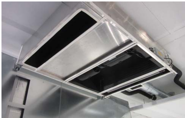
Abbildung 5: Revisionsöffnung für Ventilator und Wärmetauscher.
