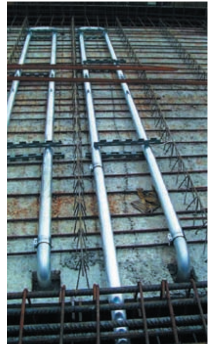
Die Kühlrohre werden gemäß dem Ausbauraster angeordnet.
