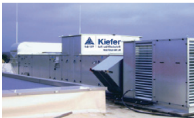
Lüftungsanlage mit integrierter Kälteerzeugung auf dem Dach
